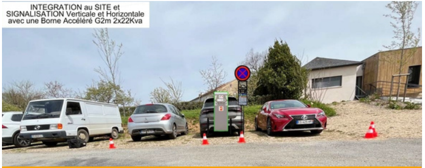
positionnement de la borne de recharge électrique à La Bastide l'Evêque
